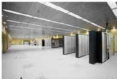
Εσωτερικός χώρος του Datacenter
